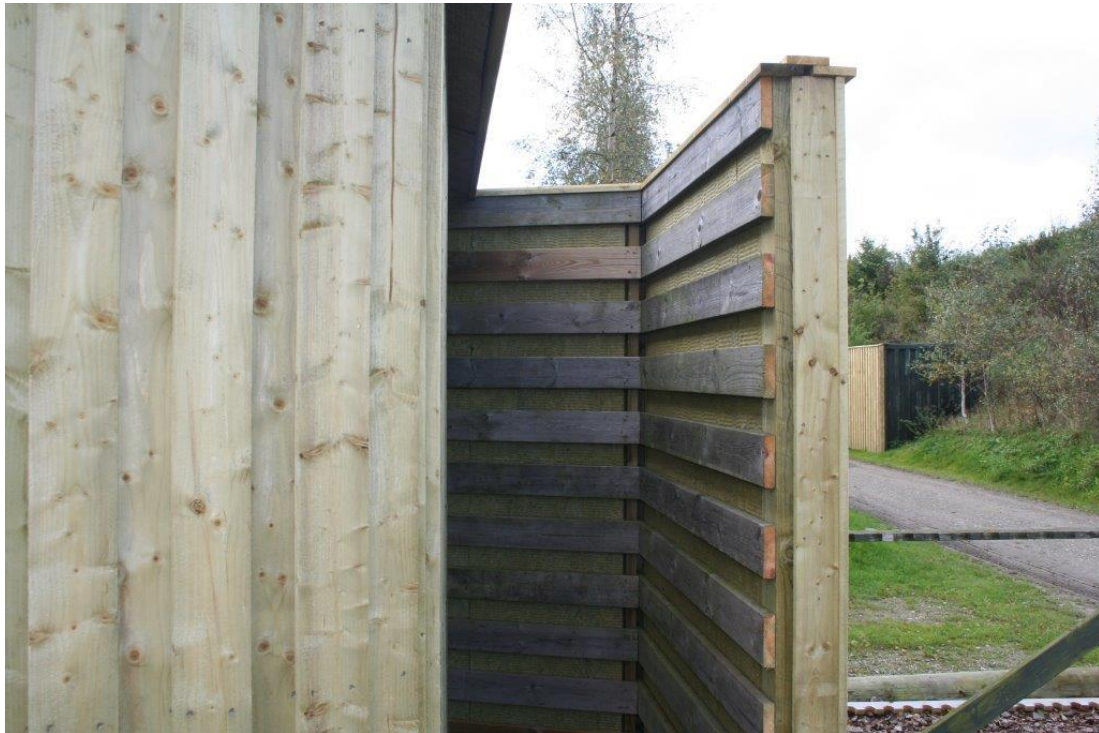
Figur 6. Foto af lydslusen. Det kan ses, at taget ikke dækker over lydslusen, hvorved der er fri passage af lyden fra skydehuset bagud.
